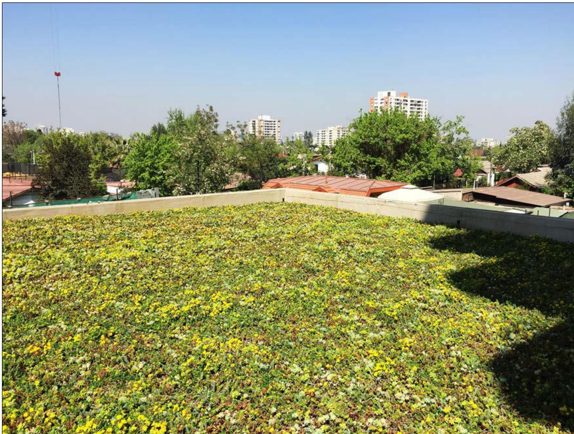
Figura 12 – Ejemplo de implementación de techo verde en Edificio Amapolas en Ñuñoa, Región Metropolitana
