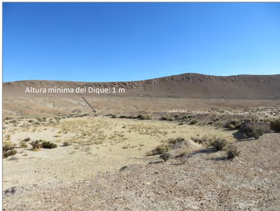
Figura 30. Dique Oeste, construido con material granular proveniente del suelo natural del sector. Fuente: Elaboración propia.
